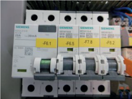
Fig. 6.7: l.t.r -F6.1, -F6.5, -F7.8 and -F8.2 protective switch
